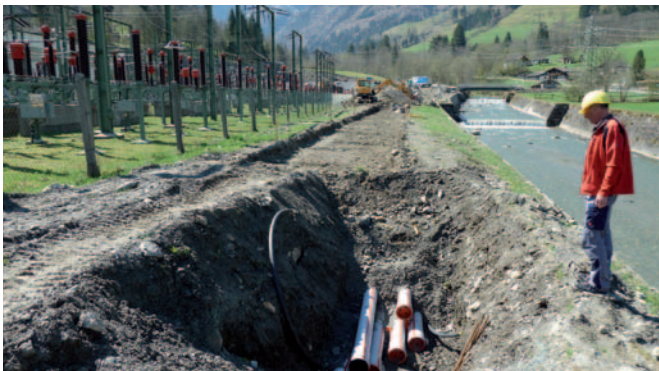
Kabeltrasse Anschluss neben der Freiluftschaltanlage
